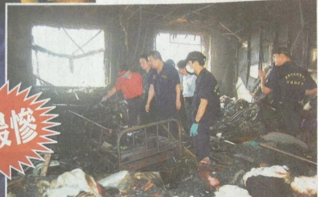
▲署新北門分院被燒成一片焦黑，鑑識人員進行現場蒐證。 (台南市消防局提供)
